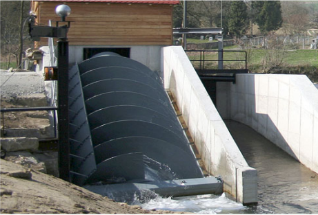
図6 水車発電機設置例 流 量:4.0(m 3 /s) 落 差:2.85(m) 最大出力:83.9(kW)
