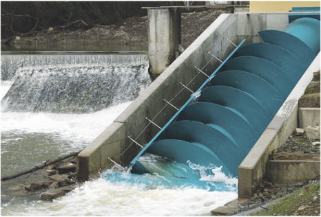
図5 水車発電機設置例 流 量:3.0(m 3 /s) 落 差:2.65(m) 最大出力:58.56(kW)
