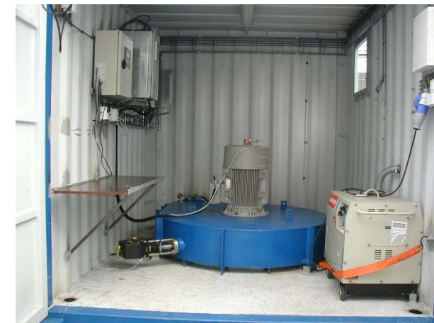
立軸ペルトン水車外観
